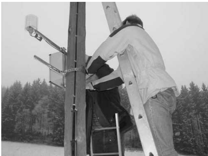
Abbildung 4: Installation einer Klimamessstation (kombinierter Messwertgeber in Schutzhütte sowie Datenlogger in Metallgehäuse) an den Standorten der vertiefenden Klimaanalyse).
